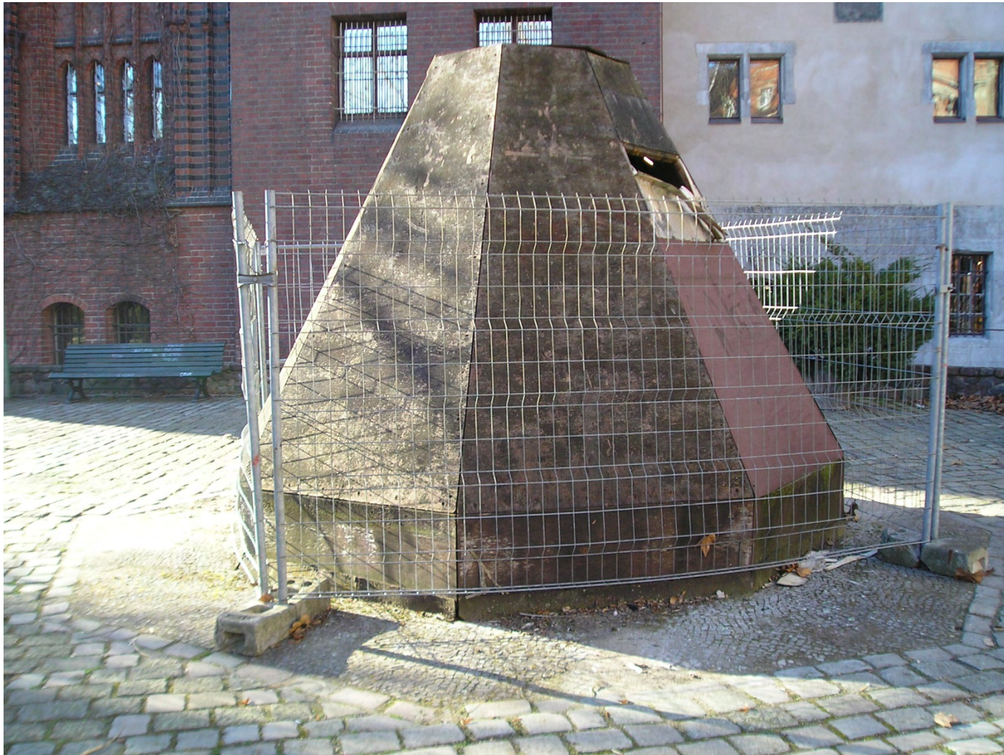
Der Terrakotta-Brunnen außer Betrieb und eingehaust, 2009
