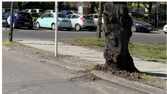
Abb. 45 Sechseck-Insel: Kleine Baumscheiben, schadhafte Fahrbahn
