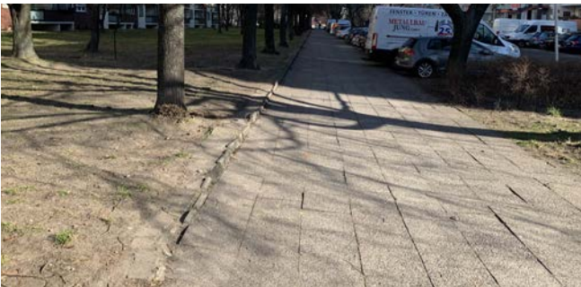
Abb. 51 Gehwegschäden auf der Westseite
