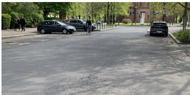
Abb. 52 Der Asphaltbelag der Fahrbahn ist brüchig
