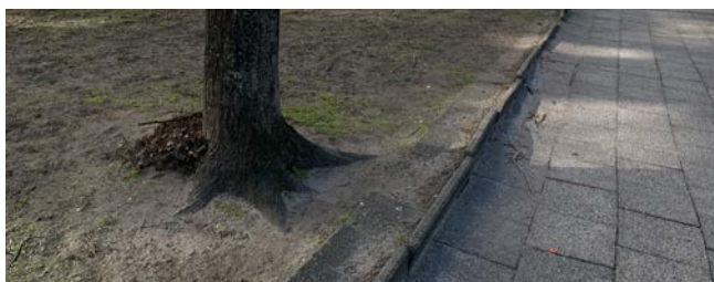
Abb. 47 Stolpergefahr durch angehobene Kantensteine und Platten
